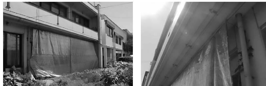
写真 I-1.2 鉄筋コンクリート造のある町役場の2階バルコニーの床裏面にカーテンレールを打ち付け、農業用の遮光スクリーン（寒冷紗）が屋外日除けとして設置された優良事例（写真提供：北瀬幹哉）
